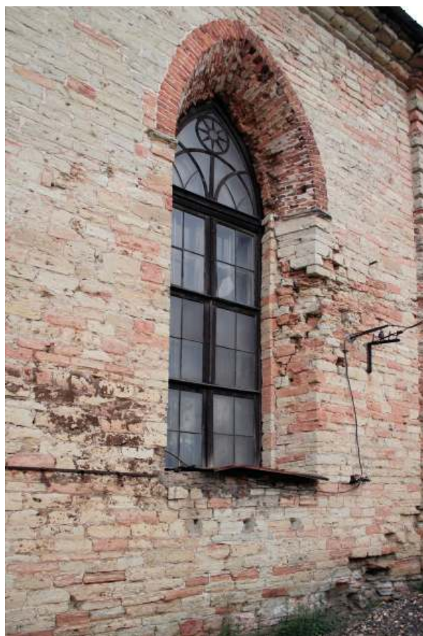
Рис. 8. «Kukkonkirkko» – «Петушиная церковь». Трещины и утраты в кладке южной стены кирпичи. Вид с юга. Фото В. Ю. Соболева
