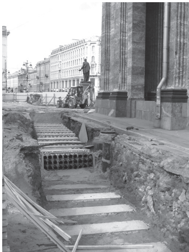
Рис. 14. Общий вид траншеи на Казанской улице с монтируемым футляром для кабельных линий электромагистралей. Вид с юга
