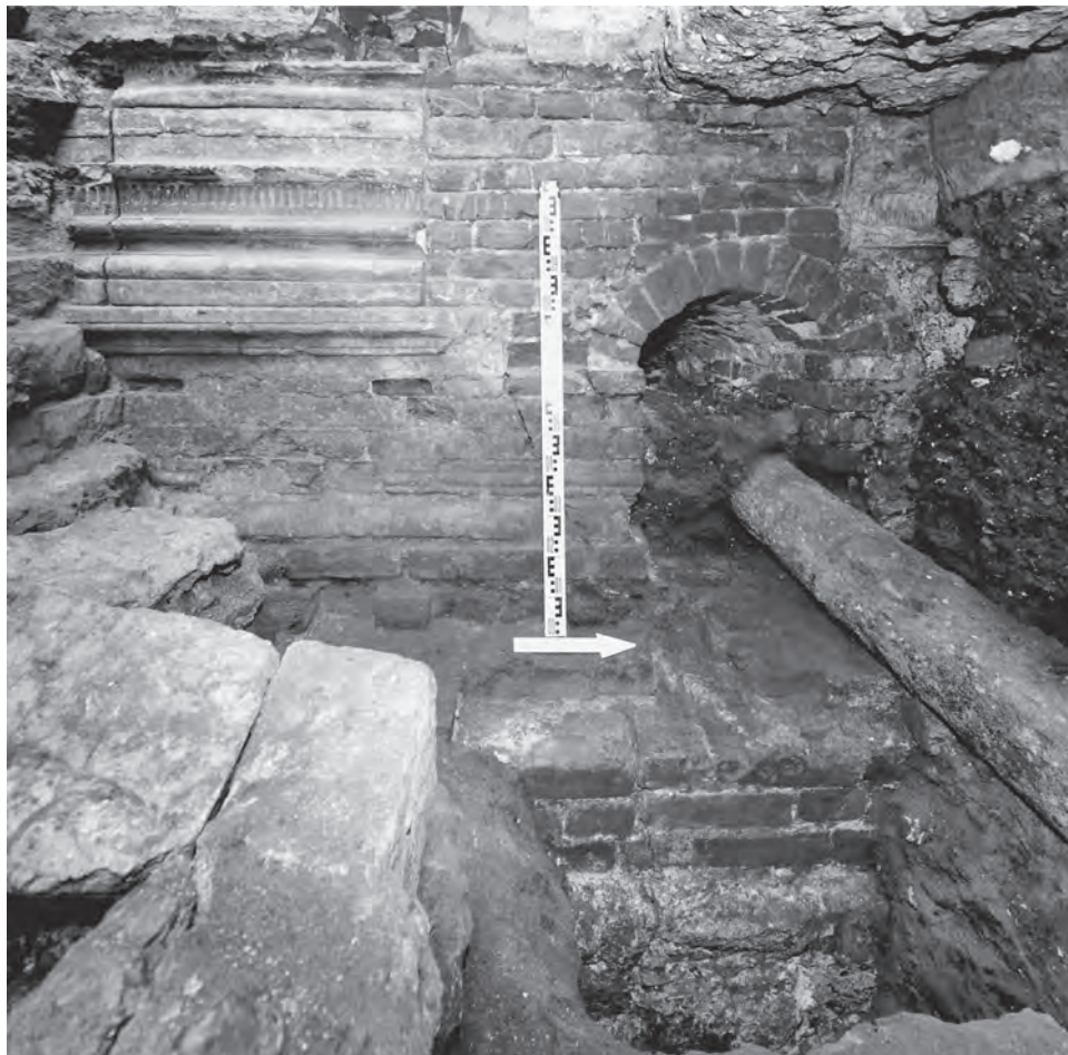
Ил. 28. Москва, Московский Кремль, Грановитая палата. Траншея вдоль северного фасада здания. Участок возле арки XVII в. и восточного фасада северного корпуса Большого Кремлёвского дворца. Общий вид белокаменного цоколя нач. XVI в. северного корпуса дворца
