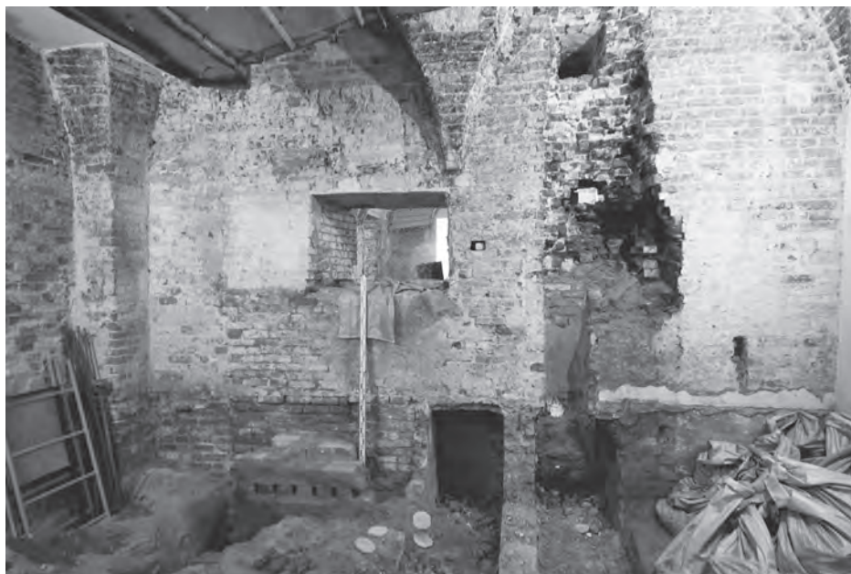
Ил. 24. Москва, Московский Кремль, Грановитая палата. Остатки калориферной системы, устроенной в XIX в. на участке юго-западного помещения подклета. Вид с запада
