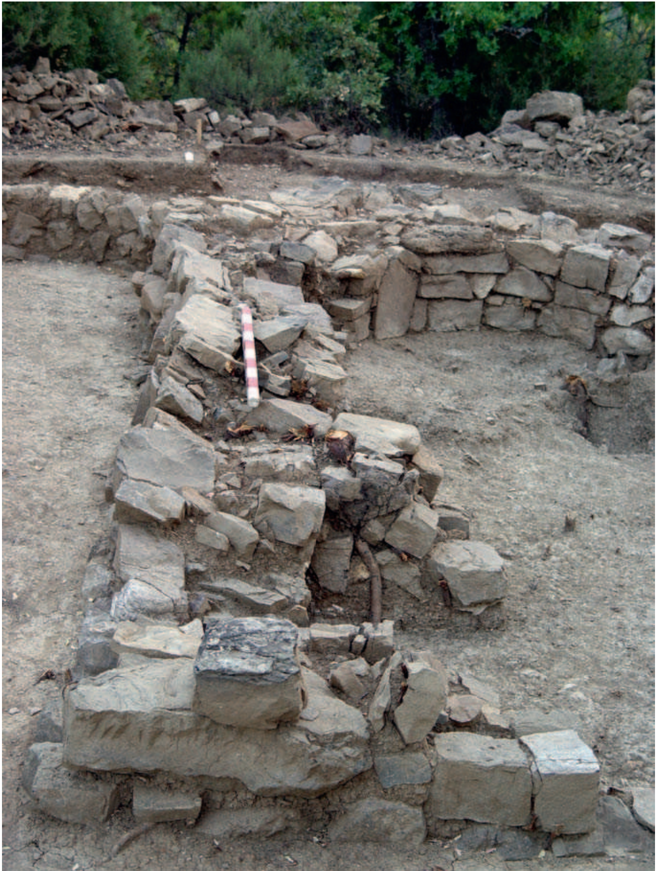
Рис. 1.49. Деформация кладки стены между компартиентами. Общий вид с юго-запада. Fig. 1.49. Deformation of the wall masonry between southern and northern parts of the church, view from southwest.
