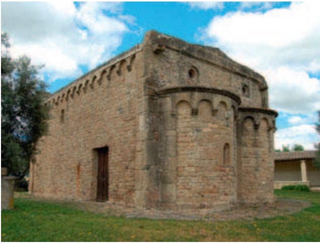
Рис. 14.11. Двухапсидный храм Санта-Мария-ди-Сибьола, Сердиана, Сардиния, Италия, XII в., вид с юго-востока. Fig. 14.11. Double apse Santa Maria di Sibiola church, Serdiana, Sardegna, Italy, 12 th century, view from southeast.
