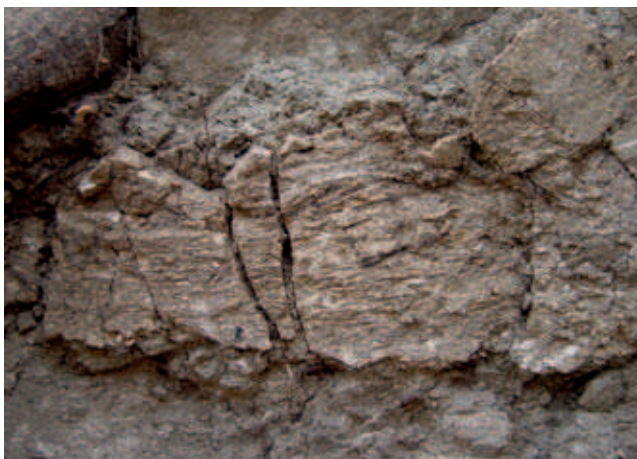
Рис. 1.35. Остатки известковой штукатурки со следами затирки поверхности травой.
