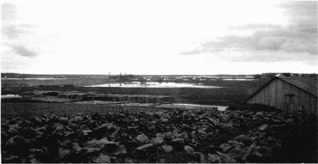
Рис. 9. Вид на строящуюся железнодорожную насыпь у церкви Спаса на Нередице. Снимок П. П. Покрышкина, 1917 г.
