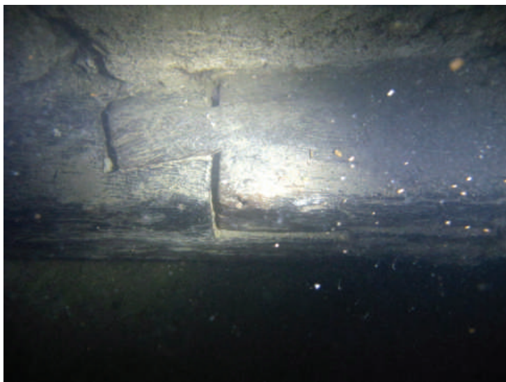
Рис. 72. Акра. Стыки дубовых балок основания башни
