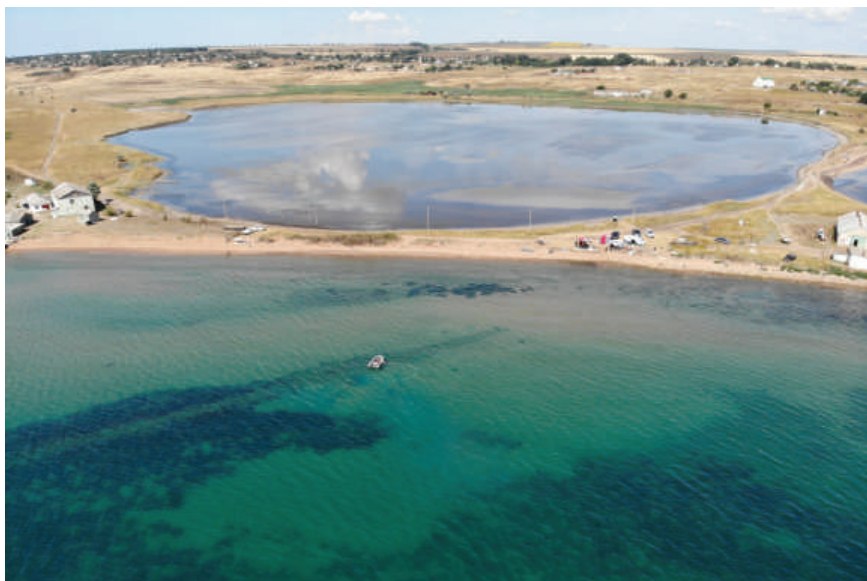
Рис. 66. Акра. Аэрофотосъемка рабочего момента по расчистке оборонительной стены. Водолазный пост с лодкой расположен на месте работ на участке «2019»
